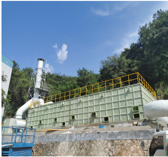
生物除臭设施及排气筒
