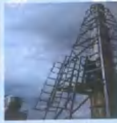
DA001 废气排出口
