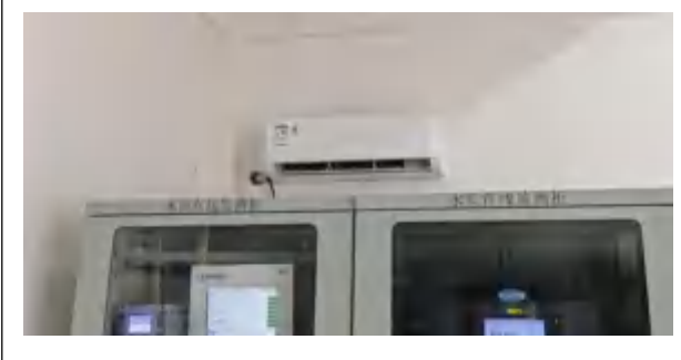
监测站房内空调
