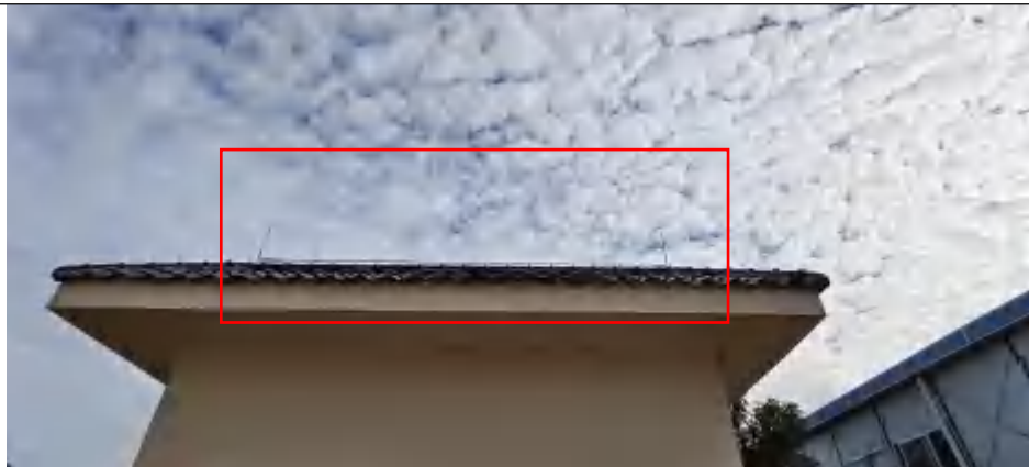
监测站房防雷设备
