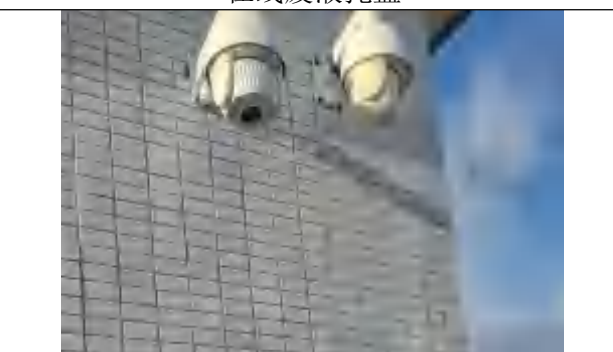
采样口处监控摄像头
